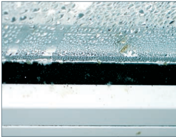
Erhöhte Gefahr von Tauwasser- und Schimmelbildung durch herkömmliche Abstandhalter aus Aluminium
